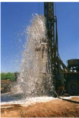
Frisches Wasser aus der Erde: Im Tschad sind Brunnenbohrungen aufwendig & kompliziert, angesichts der Wasserknappheit aber dringend notwendig.
